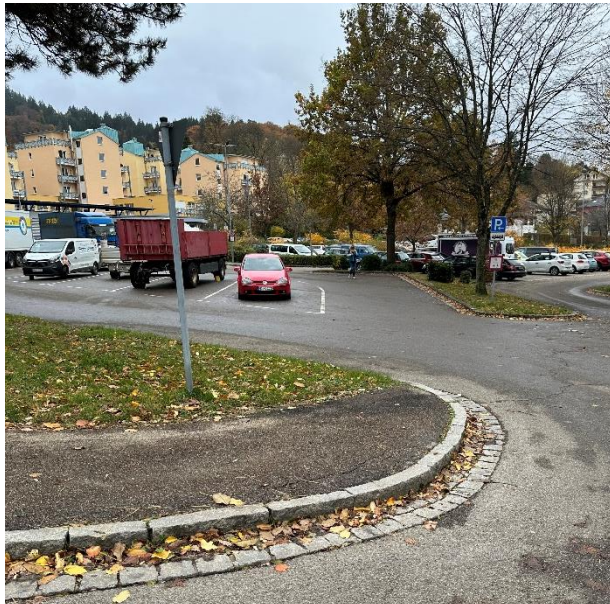
Abbildung 37: Fehlende Bordsteinabsenkung Ernst-Eisenlohr-Straße / Parkplatz Ost
